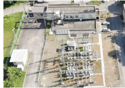
新桂沢発電所
