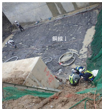
令和2年 熊追発電所接地工事状況 (埋め戻し前にアース線布設)
